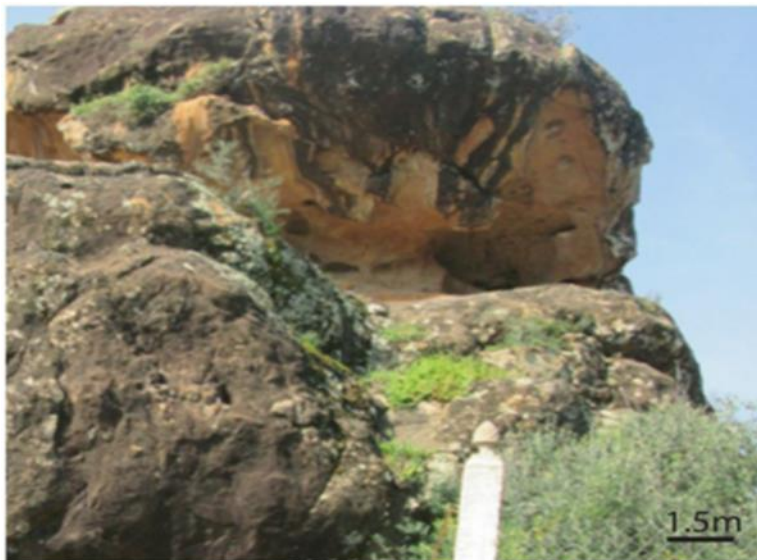
Figure 7 : biodégradation de l'abri ; colonisation par algues sur le ruissellement, lichens, plantes et arbustes.
